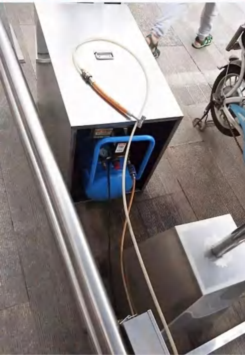
存车区配备打气泵，帮助顾客给车打气。
